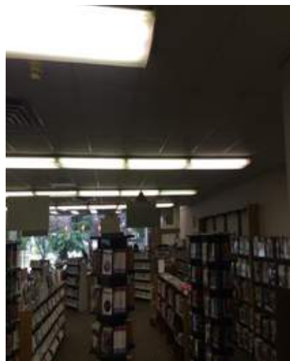
E11 _Main Area Lighting
