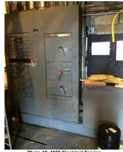
E10 _Electrical Service-1959
